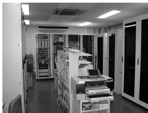
図 3.8: コンピュータ室
